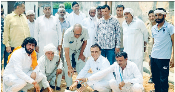
बहादुरगढ़। नारियल फोड़कर गली निर्माण कार्य का शुभारंभ करते विधायक राजेश जून।
